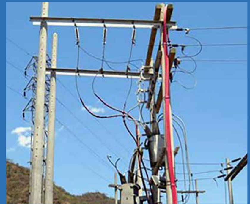
Celda de Alimentador 22,9 KV OI-201 SET Olmos
