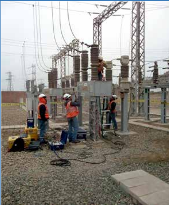
Pruebas eléctricas a interruptores SET Chiclayo Oeste
