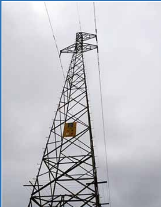
Línea 60 kV L-6039 Lambayeque Íllimo
